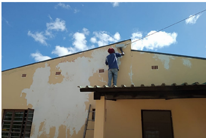
■ Saneamento de humidade. O clima em Moçambique causa problemas de humidade em muitos dos projetos.
