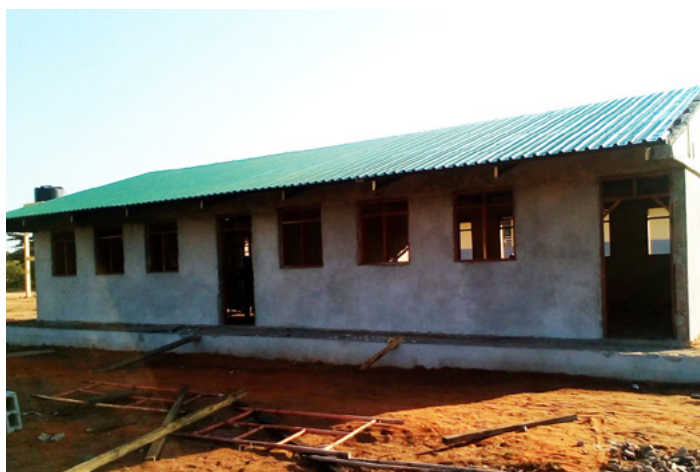
■ Construção de duas novas salas de aula na E. Secundária Siegfried Lingel.
