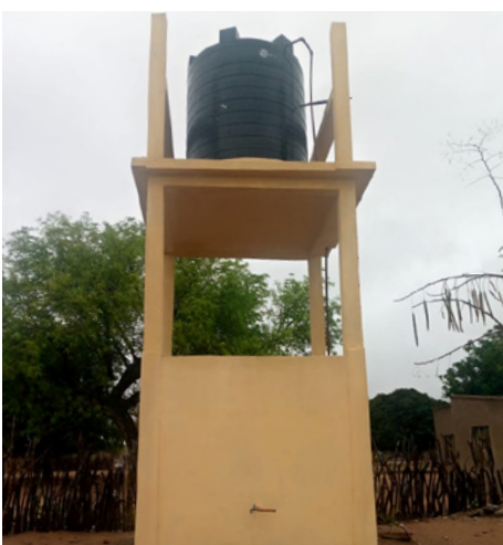
■ Mit dem neuen Wasserturm in Matidze ist die Wasserversorgung jetzt gewährleistet.
